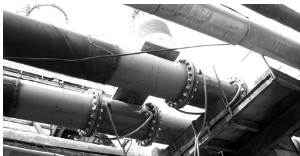
Рис. 4. Двухканальный ультразвуковой тепловосчетчик СВТУ-10М с диаметром условного прохода 600 мм, установленный на ТЭЦ
